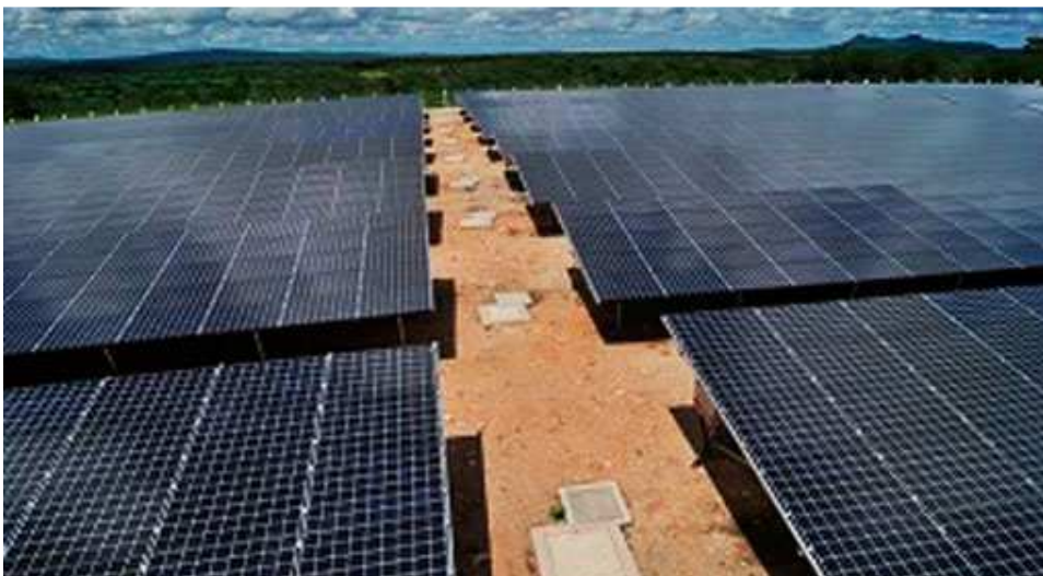
Figura 2.10 – Visão geral da usina fotovoltaica de Tauá
