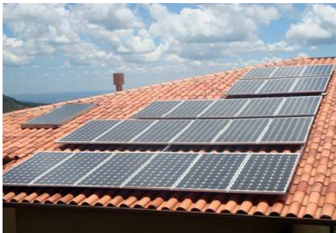
Figura 2.8 - Módulos fotovoltaicos integrados ao telhado
