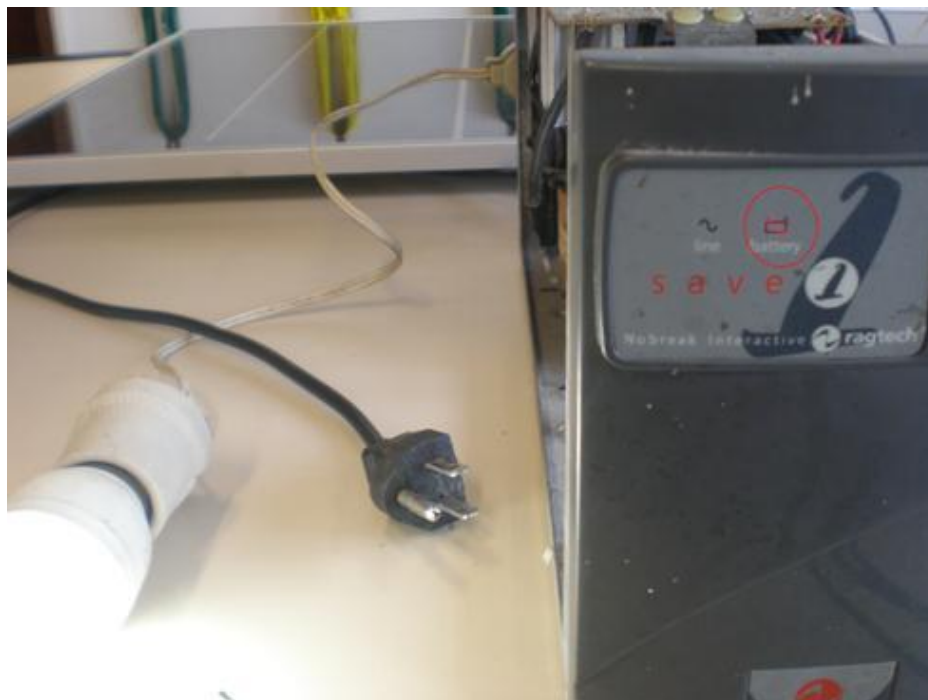
Figura 8.11 - No-break operando sem fornecimento da rede
