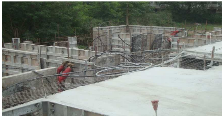
Figura : Operação de desforma e montagem do sistema de fôrmas de parede Fonte: Construtora Tenda – Acervo de Obra
