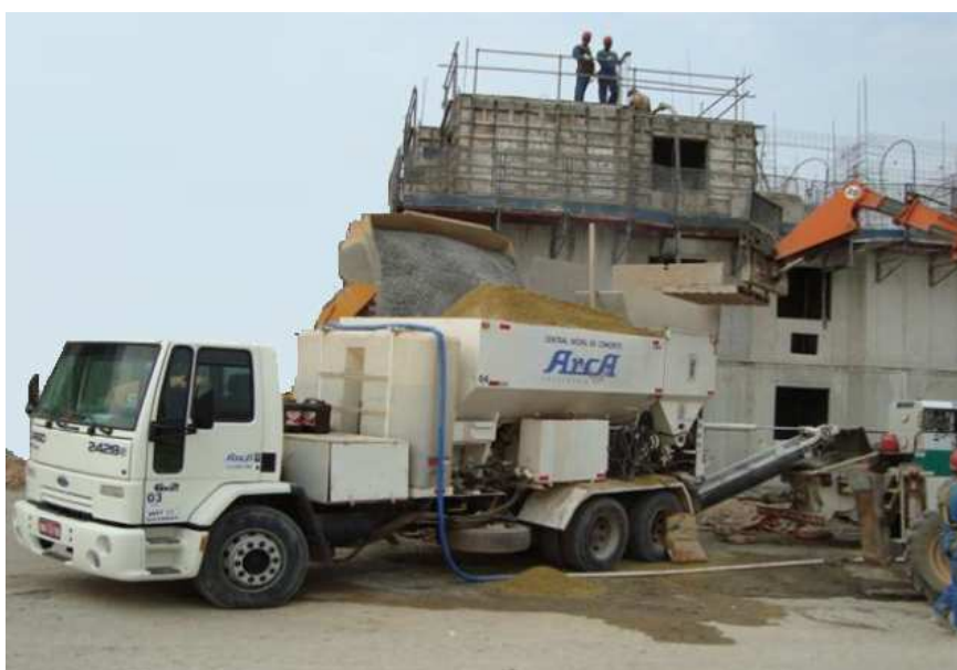
Figura : Usina móvel de concreto. Fonte: Autor, 2010
