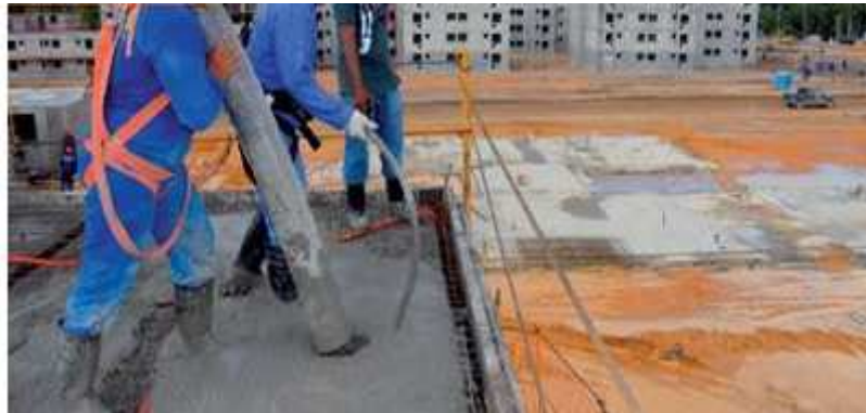
Figura : Operação do magote da bomba de concreto e do mangote do vibrador mecânico Fonte: http://www.equipededeobra.com.br/construcao-reforma/47/artigo257752-1.asp
