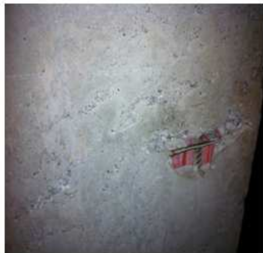
Figura : Superfície mal adensada resultou em bolhas de ar, segregação do concreto e buraco na parede. Fonte: Construtora Tenda – Acervo de Obra.
