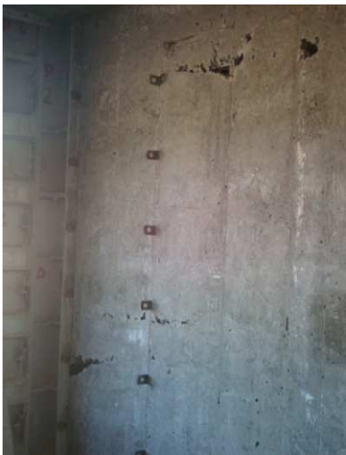
Figura : Superfície de concreto imperfeita. Fonte: Autor, 2010
