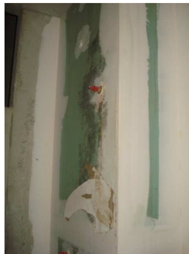
Figura : Infiltração na prumada de água.
