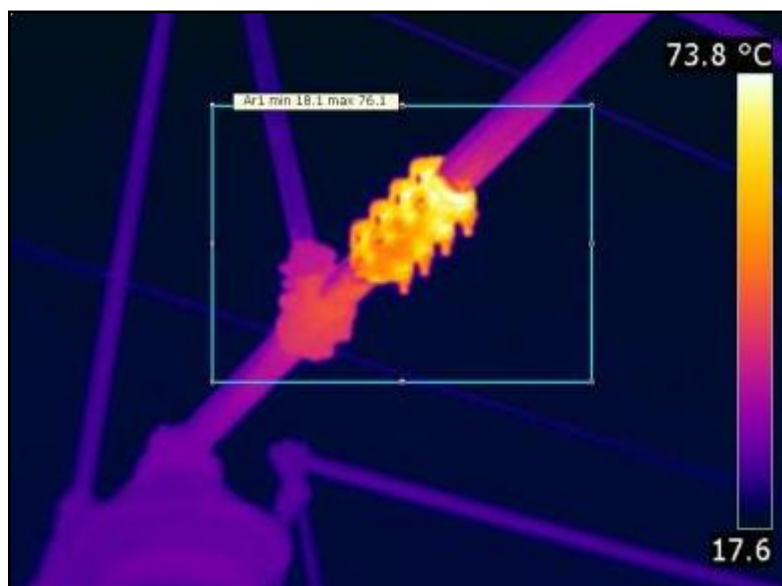
Figura 4 - Exemplo de Termograma de uma Conexão de Barramento com Ponto de Aquecimento
