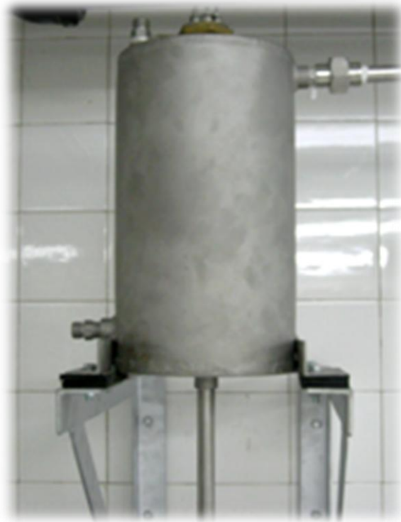
Figura 2.2 - Tanque de abastecimento do circuito primário.
