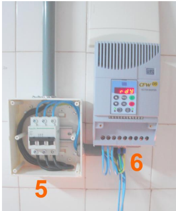
Figura 2.34 - Disjuntor do inversor e o inversor de frequência da bomba do circuito primário.
