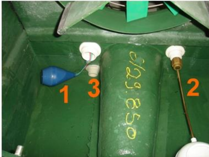
Figura 2.31 - Visão do interior da torre de resfriamento
