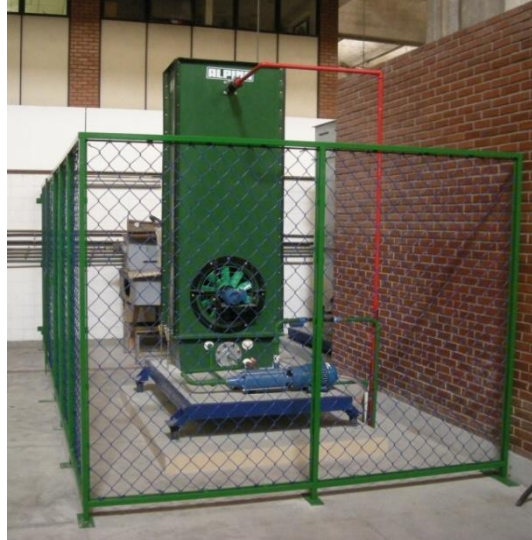
Figura 2.28 - Conjunto bomba-torre de resfriamento
