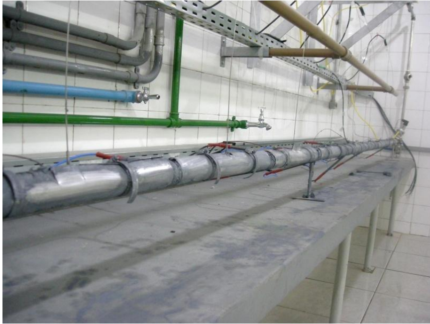
Figura 2.15 - Resistências elétricas com pasta térmica envoltas em chapa de alumínio.
