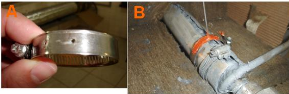
Figura 2.16 - A- Abraçadeira de fixação dos termopares ; B – Abraçadeira instalada no tubo.
