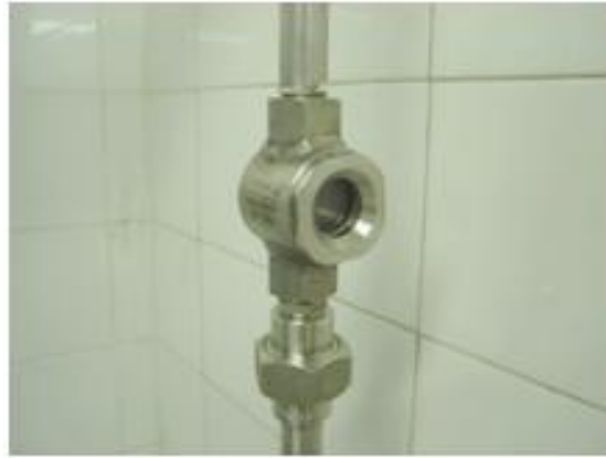
Figura 2.20 - Visor de fluxo do circuito primário
