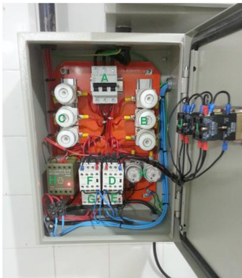
Figura 2.36 - Quadro de controle do circuito secundário
