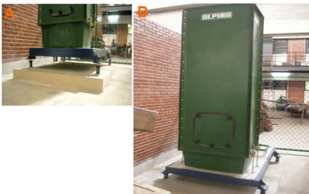
Figura 2.27 - Torre de resfriamento do circuito secundário A (base) e B (visão parte traseira do conjunto).
