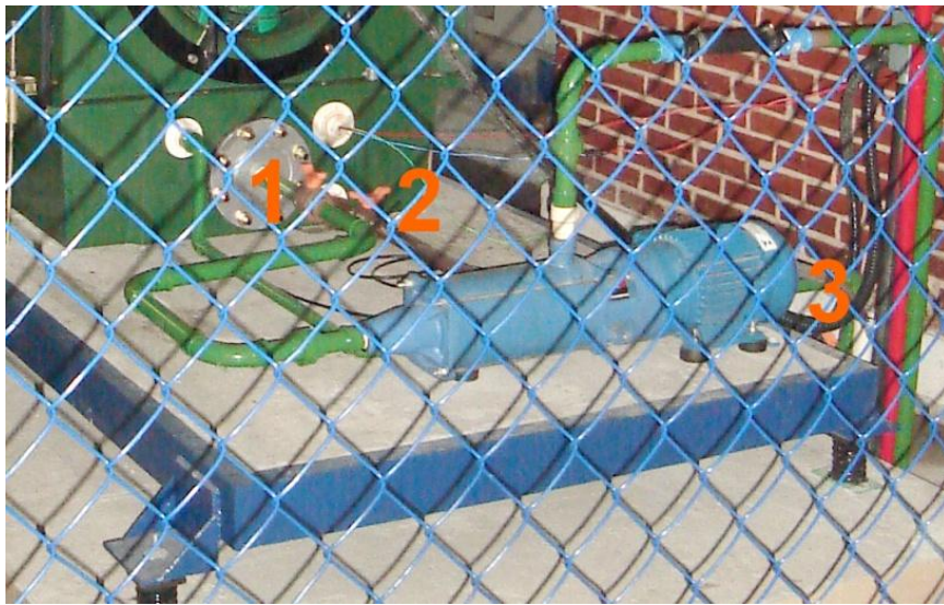
Figura 2.30 - Válvulas do circuito secundário.
