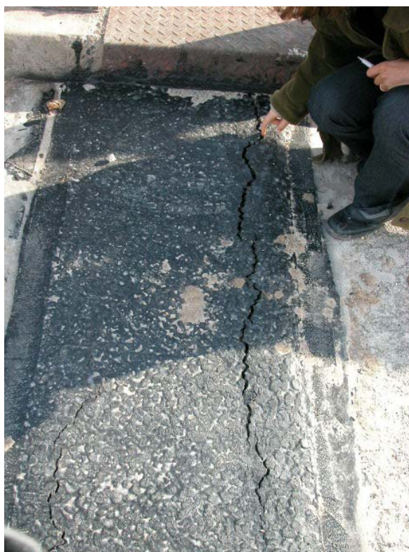
Figura 1 – Fissuração em uma junta de betume, LIMA et al (2007).
