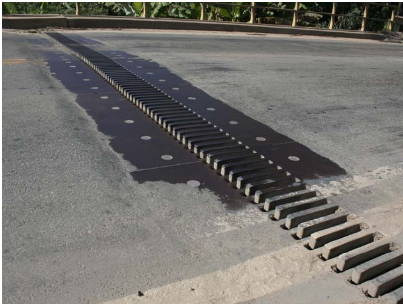
Figura 7 – Desnível causado por movimentação de junta de dilatação na ponte metálica da BR- 458, LIMA et al (2007).
