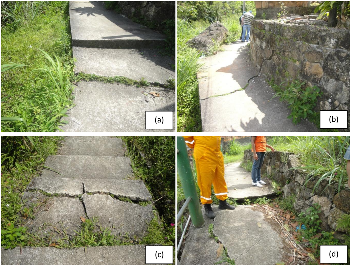
Figura 13 – Trincas no solo e calçamento do Sapinhatuba I (visita 04/11/2011)
