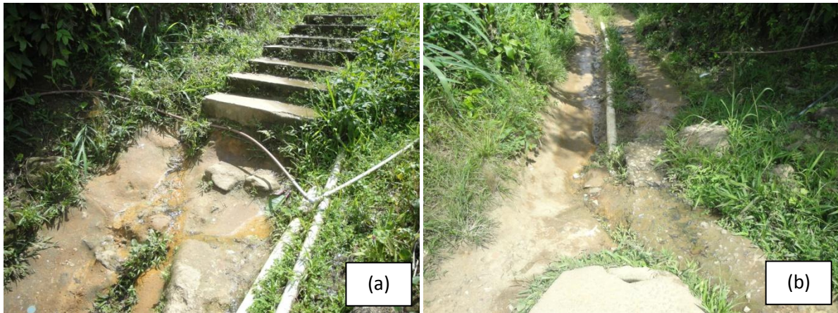
Figura 10 – Tubulações de água e esgoto deficientes (visita 04/11/2011)
