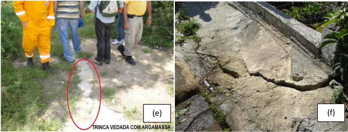
Figura 13 – Trincas no solo e calçamento do Sapinhatuba I (visita 04/11/2011)
