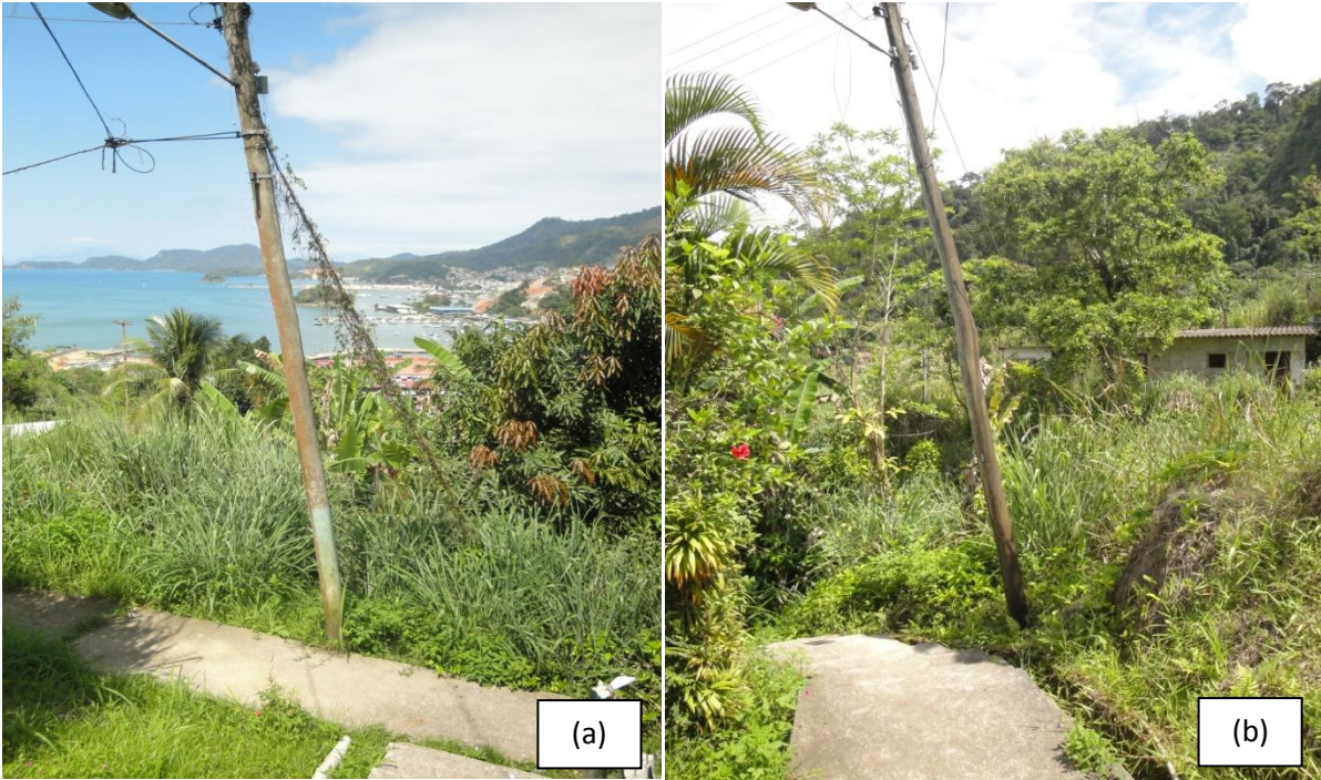
Figura 12 – Postes desaprumados (visita 04/11/2011)
