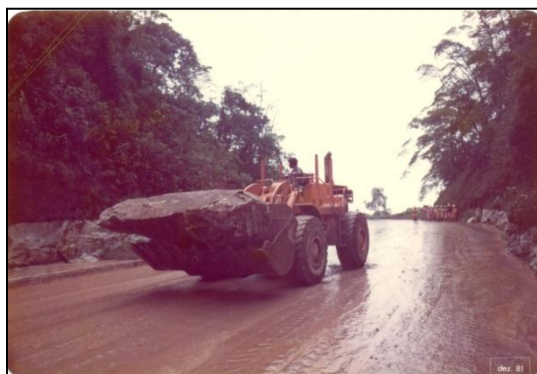
Figura 3.3. Remoção de bloco após queda na rodovia estudada.
