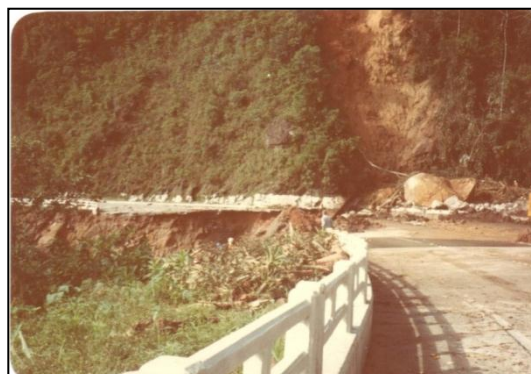
Figura 3.4. Queda de blocos na rodovia estudada.
