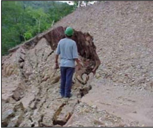
Figura 2.1 - Ruptura Circular (Nunes 2008).
