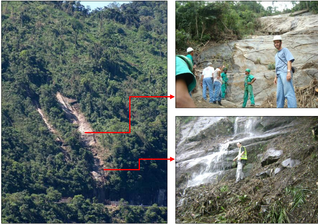
Figura 3.14 - Cicatriz gerada pelo deslizamento com detalhe do talude na cicatriz e fluxo de água oriundo das fraturas (Modificado de CRT, 2010).
