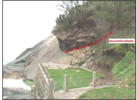
Figura 2.2 - Ruptura Planar (modificado de Nunes, 2008).
