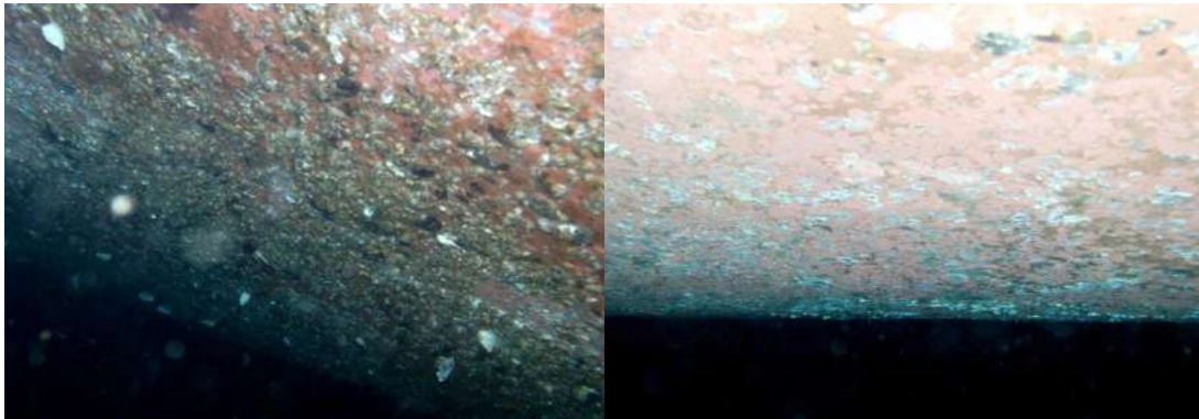
Figura 2 – Comparação da condição do casco antes e depois da limpeza.
