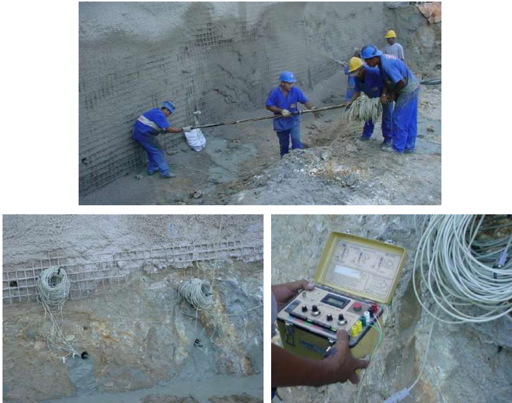
Figura VI.21 – Etapas da instalação das barras: (a) colocação da barra instrumentada no furo pré-aberto; (b) situação logo após injeção de calda de cimento (c) realização da leitura inicial.
