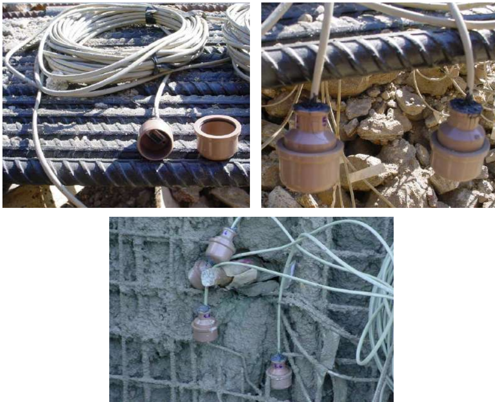
Figura V.17 – Conectores e terminais protegidos por meio de caixas “blindadas”.
