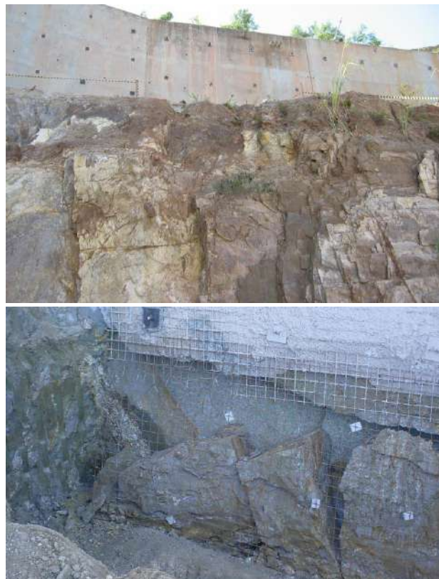
Figura V.23 – Rupturas na ocorrência 1 (Morro Boa Viagem; Ehrlich e Silva, 2012).
