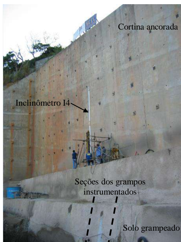
Figura VI.12 – Instalação do tubo de acesso ranhurado referente à vertical inclinométrica I4, adjacente à seção dos grampos instrumentados com strain gages .
