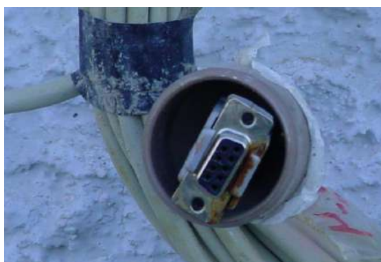
Figura VIII.11 – Danos nos sistema de leitura por infiltração de água.
