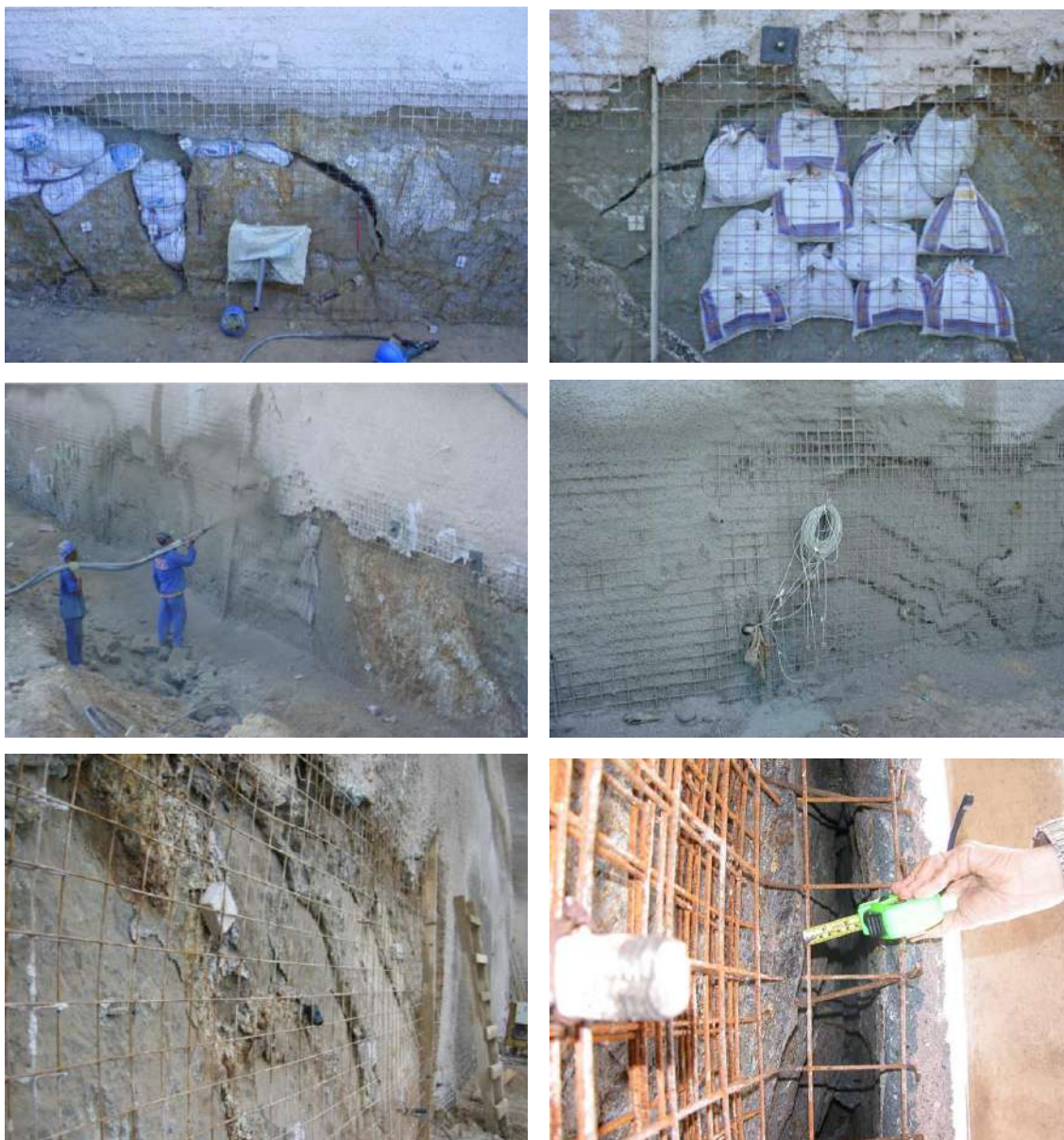
Figura VIII.13 – Rupturas localizadas na face da escavação.
