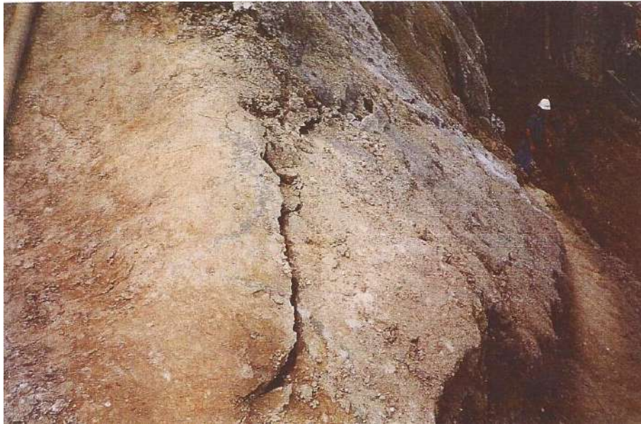
Figura VI.3 – Aparecimento de trinca na encosta a montante da cortina ancorada.
