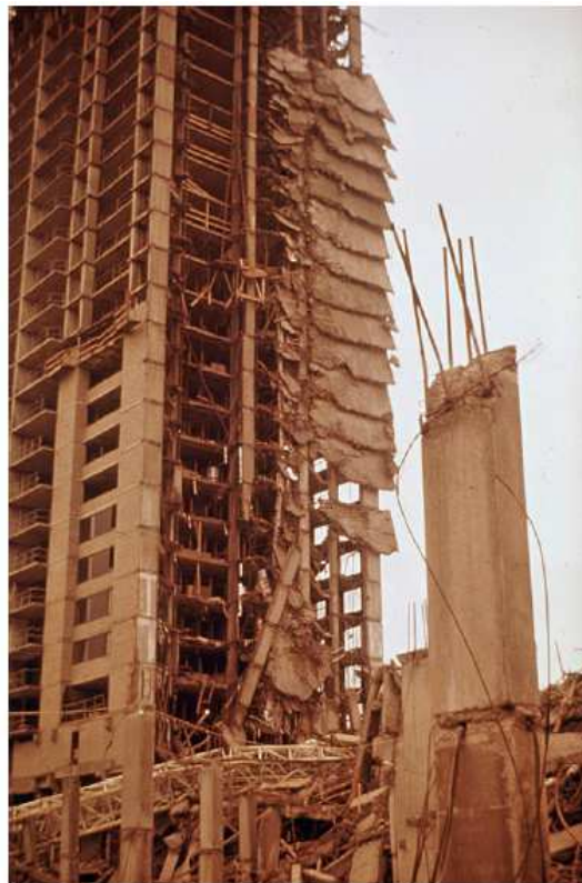
Figura 5.30 – Edifício A-4 após o colapso (SCHELLHAMMER, DELATTE e BOSELA, 2013)
