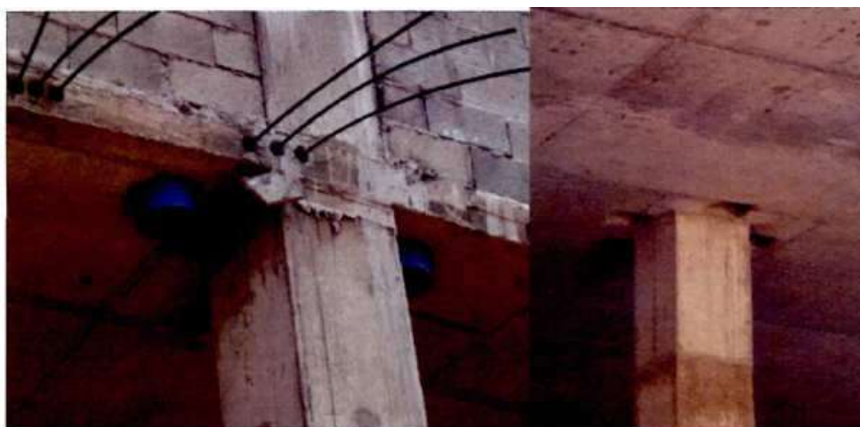
Figura 5.15 – Furos existentes nas lajes junto às faces dos pilares do Shopping Rio Poty (CREA-PI, 2013)
