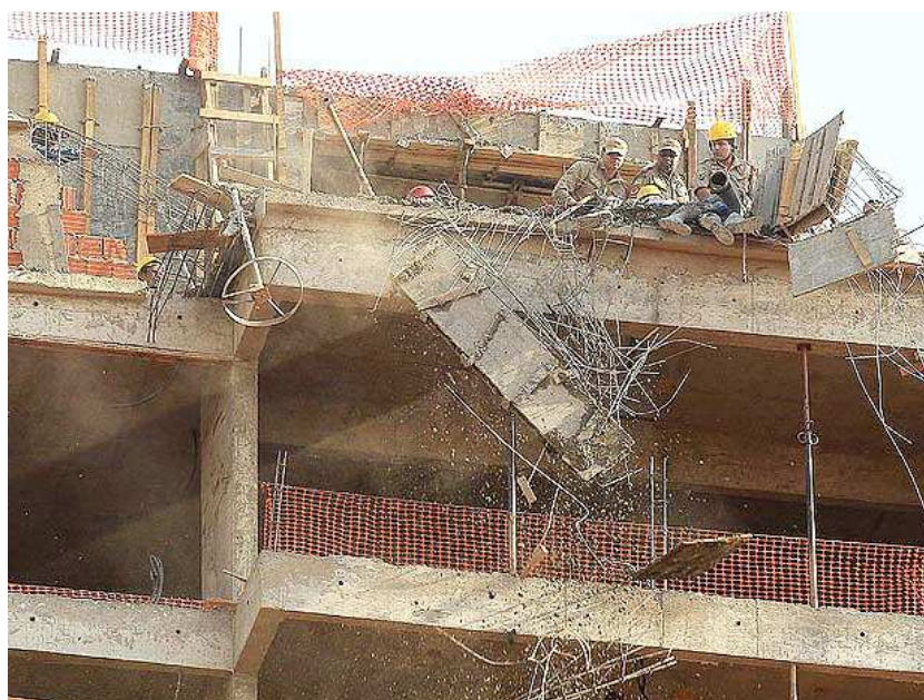
Figura 5.23 – Parte da estrutura do residencial Esmeralda remanescente (PORTAL TERRA, 2011)
