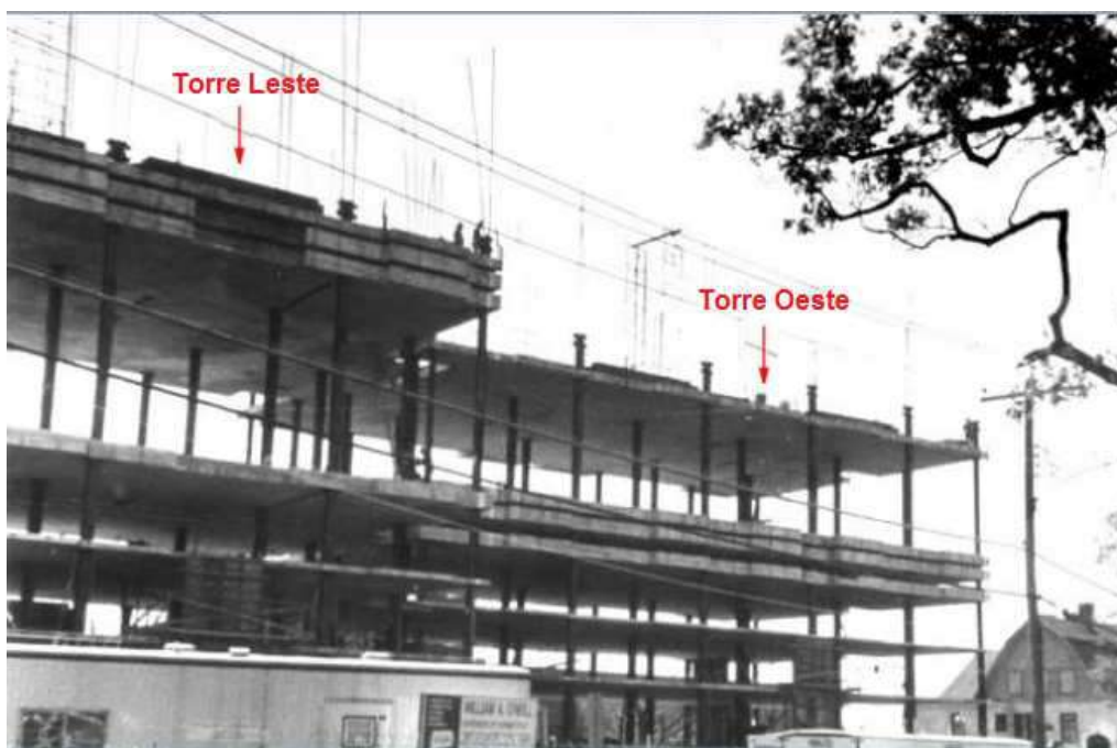
Figura 5.34 – L'Ambiance Plaza durante a fase de construção (McNAMARA e PARFITT, 2010)
