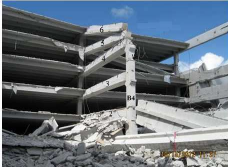
Figura 5.48 – Vigas tipo “double tee” no chão depois do desabamento do edifício-garagem na Florida (OSHA, 2013)
