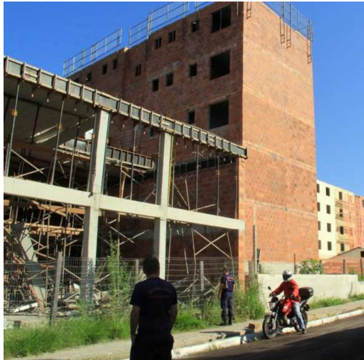
Figura 5.24 – Vista do edifício em Novo Hamburgo após colapso de parte da laje superior (JORNAL NH, 2015)
