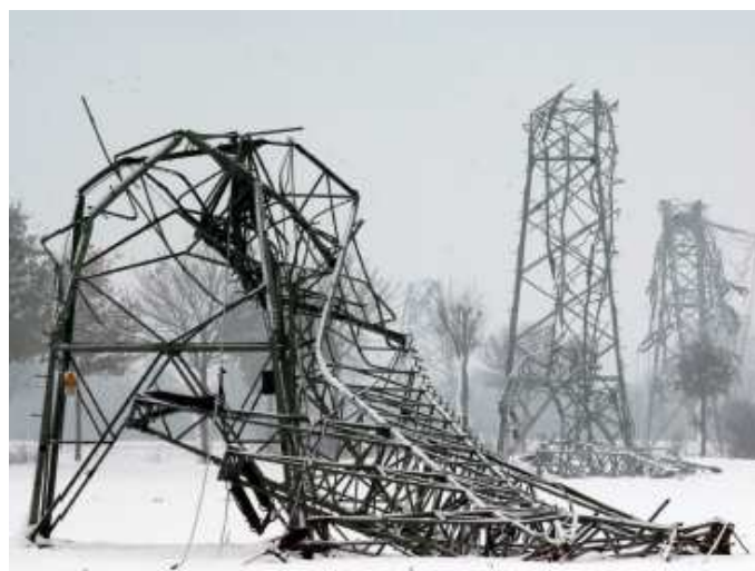
Figura 2.4 – Exemplo de colapso do tipo dominó (STAROSSEK, 2009)
