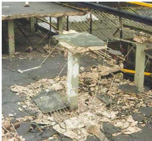
Figura 5.37 – Pilar e parte da laje intactos após o colapso do Pipers Row Car Park (WOOD, 2003)
