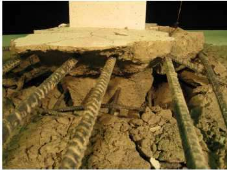
Figura 6.6 – Aspecto pós-ruptura por punção de região de pilar interno, mostrando a armadura de integridade e o “tronco de pirâmide de punção” (HABIBI, 2012)
