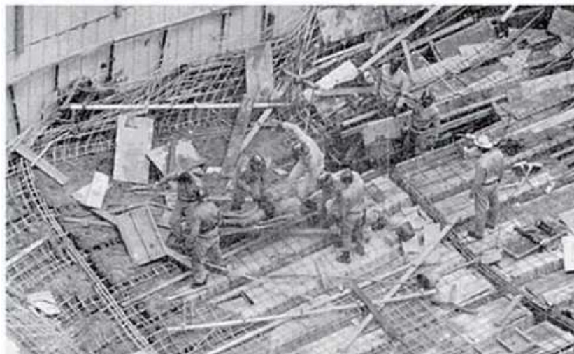
Figura 5.11 – Colapso do edifício que seria um anexo do Hotel Intercontinental no Rio de Janeiro, em 1993 (VELLOSO, NAEGELI e VIDEIRA, 1998)
