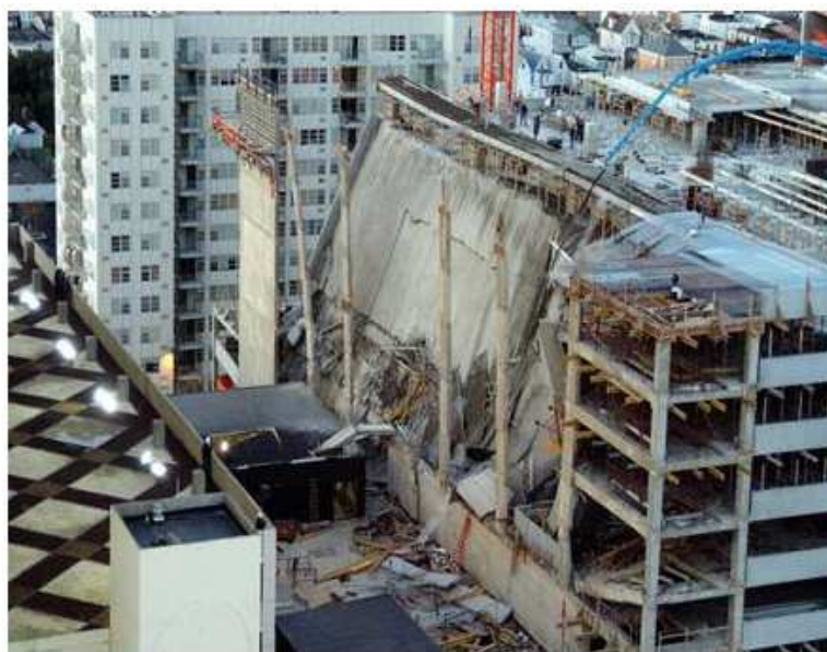
Figura 5.40 – Quatro pilares e uma parede permaneceram em pé após o colapso do edifício-garagem do Tropicana Casino Resort (OSHA, 2004)
