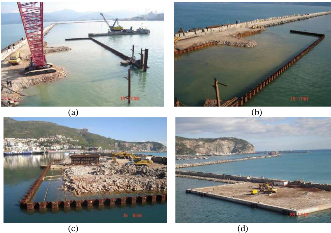
Figura 2.14. Etapas da construção do Cais Misto de Bejaia – Argélia: (a) instalação das estacas – I, (b) instalação das estacas – II, (c) aterramento e (d) conclusão da obra (ICSA, 2017).
