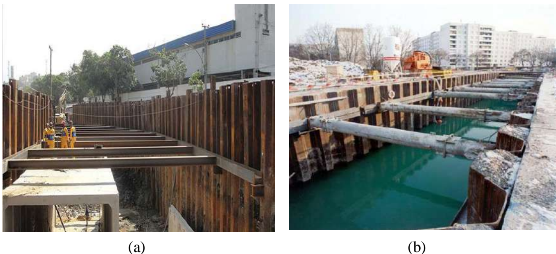
Figura 2.11. Aplicações das estacas-prancha: (a) escavação de vala para galeria subterrânea (AECWEB, 2017) e (b) contenção de canal de esgoto (DHABI-STEEL, 2017).
