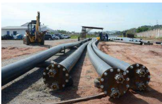
Figura 69 - Tubos das Adutoras que Atenderão a Guaratiba Fonte: CARDOSO (2017)
