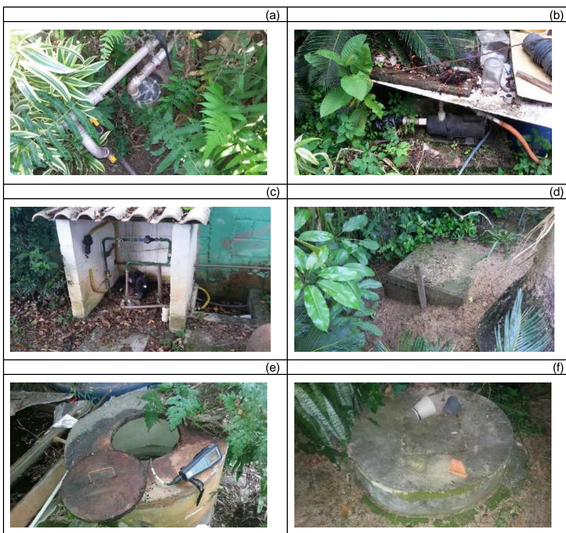
Figura 126 - Aspecto de captação em poço tubular raso (1) (a)
