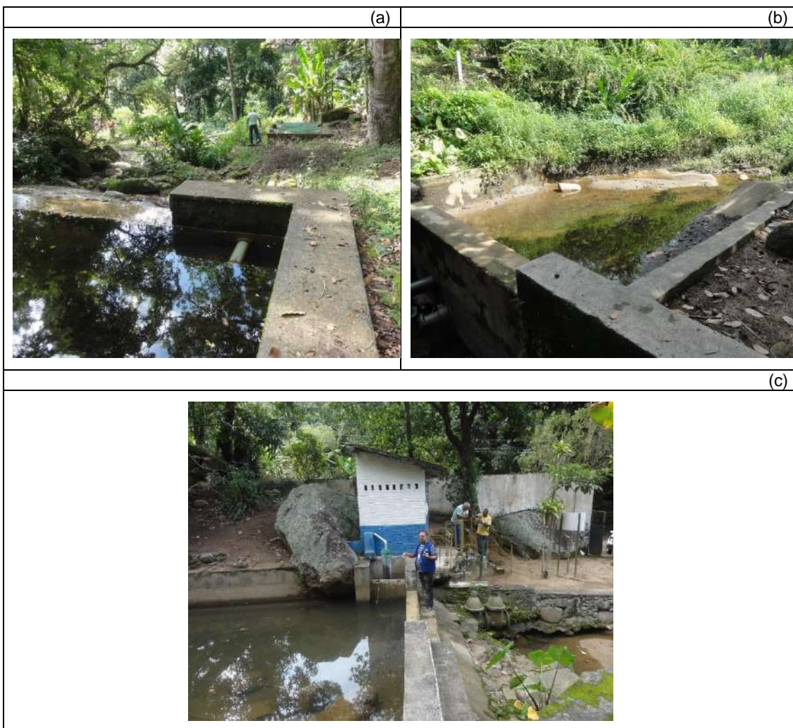
Figura 70 - Represa das Tachas e ao fundo Caixa de Areia (filtração) (a)
