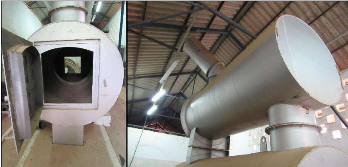
Figura 45: Aterro Sanitário de Pedro do Rio – incinerador de Resíduos do Serviço de Saúde (fora de operação) Fonte: pesquisa de campo – 03/11/2016
