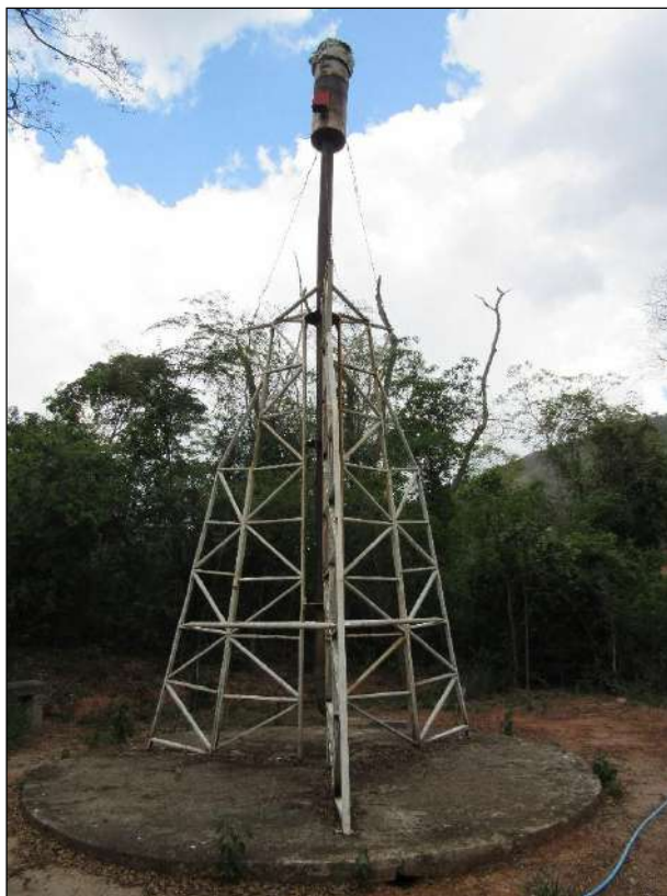
Figura 43: Aterro Sanitário de Pedro do Rio – queimador de biogás do tipo “Flare” Fonte: pesquisa de campo – 03/11/2016
