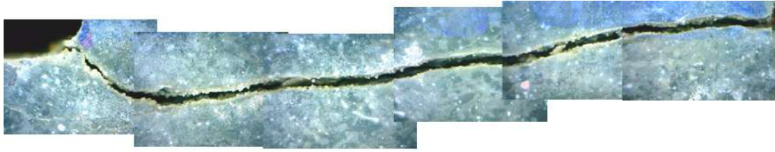
Figura 4.92: Incompleto selamento da fissura do A25
