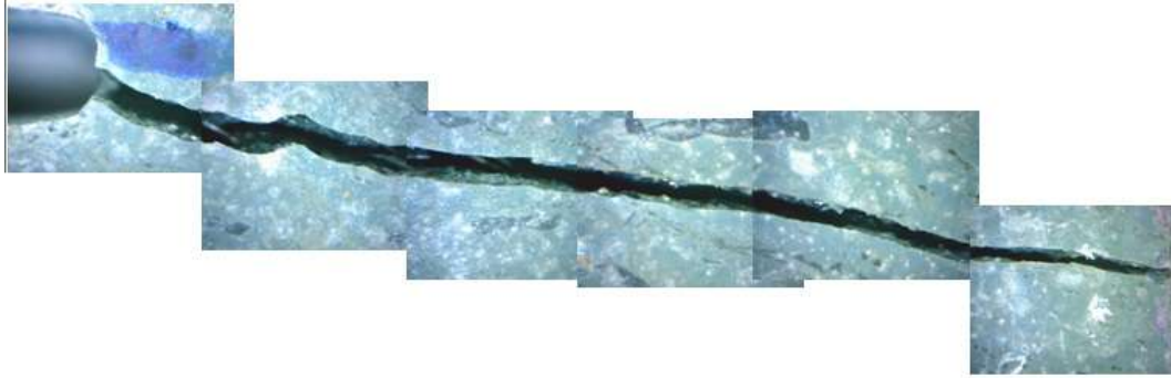
Figura 4.36: Formação da fissura da amostra A23
