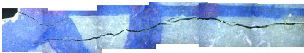
Figura 4.43: Formação da fissura da amostra B36
