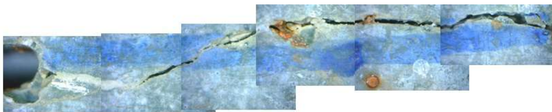
Figura 4.86: Incompleto selamento da fissura do B27
