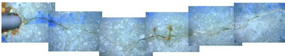
Figura 4.112: Incompleto selamento da fissura do A35
