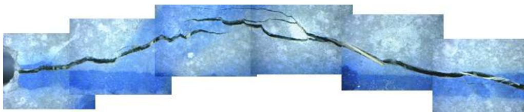
Figura 4.42: Formação da fissura da amostra C36
