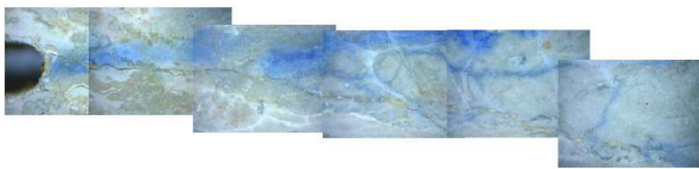
Figura 4.75: Fissura de C14 após tratamento
