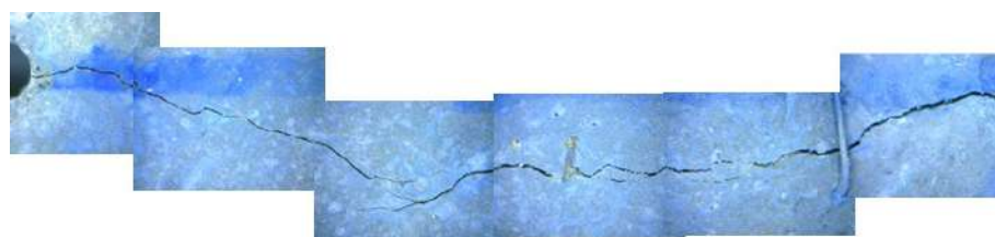
Figura 4.51: Formação da fissura da amostra A35
