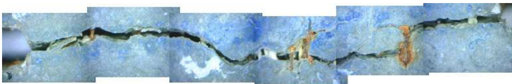
Figura 4.107: Incompleto selamento da fissura do B37
