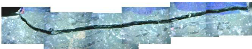
Figura 4.32: Formação da fissura da amostra A25
