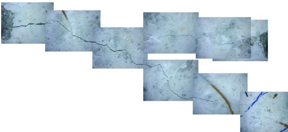
Figura 4.63: Formação da fissura da amostra B43
