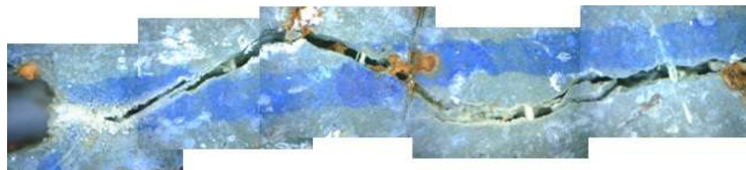
Figura 4.118: Incompleto selamento da fissura do A34
