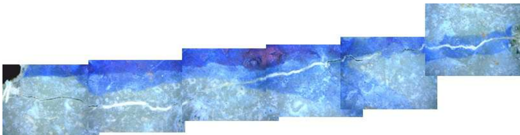
Figura 4.102: Incompleto selamento da fissura do A36
