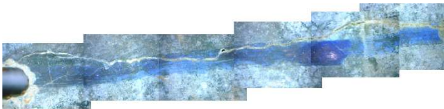
Figura 4.96: Incompleto selamento da fissura do B24
