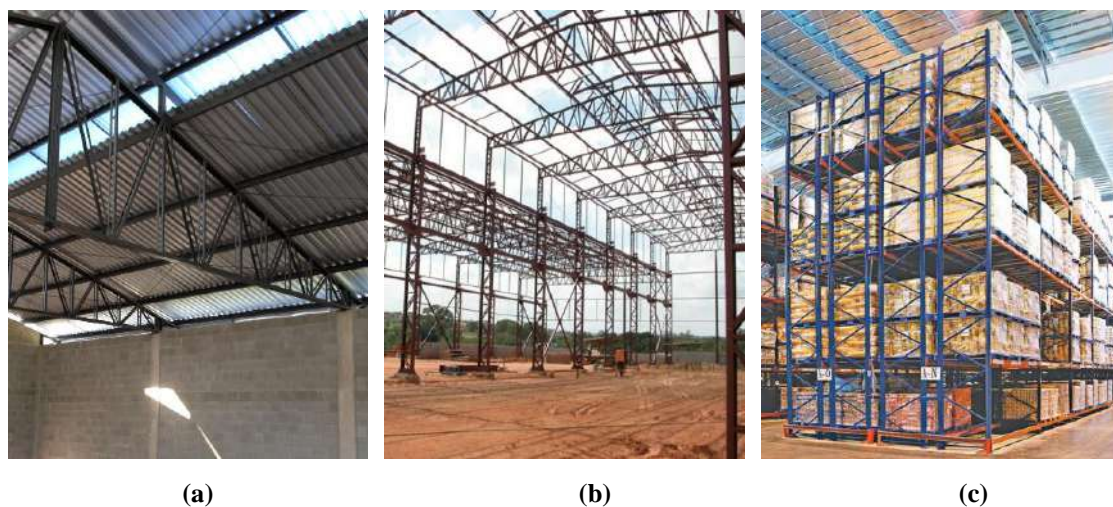
Figura 1.1. Exemplos de utilização dos PFF: (a) coberturas, (b) galpões (METALFORTE, 2016) 1 , (c) sistemas de armazenagem industrial – porta-pallets (MECALUX, 2016) 2 .
