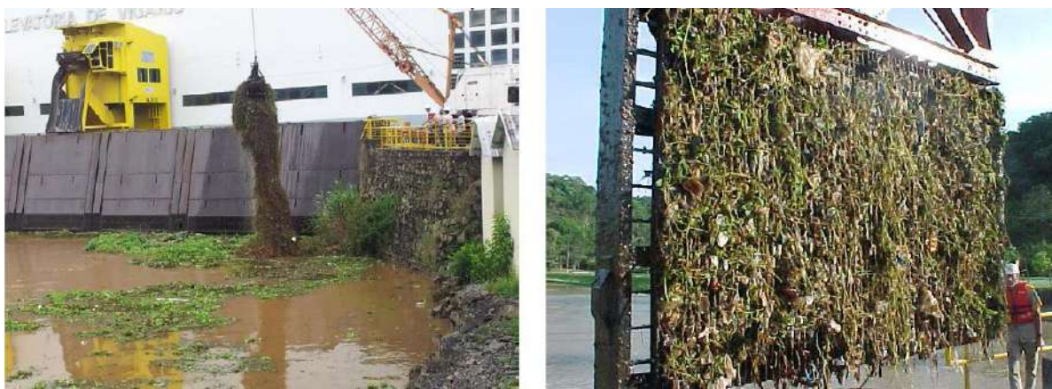
Figura 3.26 – Limpa-grades da usina elevatória de Vigário no reservatório de Santana.
