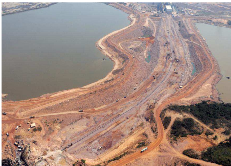
Figura 3.31: Construção da BENA - UHE Jirau: Início da construção do Núcleo Asfáltico - Agosto/2012 (RAMALHO et al., 2013)
