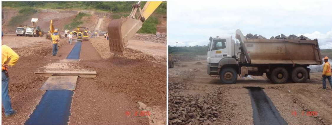
(a) (b) Figura 2.21: Ponte Metálica: a) Detalhe da Instalação da Ponte, b) Trânsito de Caminhão Sobre o Núcleo – UHE Foz do Chapecó (GUIMARÃES, 2012).
