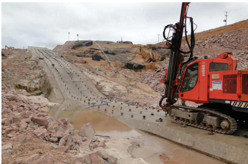
Figura 3.19: Linhas de furos de injeção de calda de cimento e perfuratriz - UHE Jirau (RAMALHO et al., 2013)
