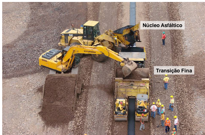
Figura 3.27: Distribuição do concreto asfáltico e da transição fina pela máquina distribuidora - UHE Jirau (RAMALHO et al., 2013)
