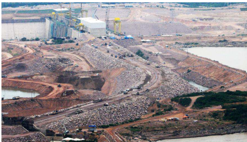
Figura 3.32: Construção da BENA - UHE Jirau: Alteamento da barragem visto da margem direita - Outubro/2012 (RAMALHO et al., 2013)
