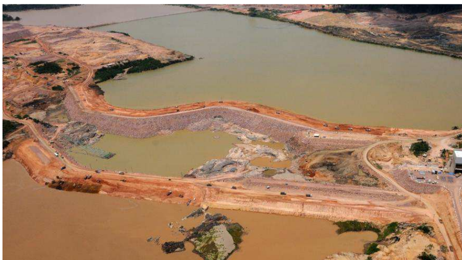
Figura 3.15: Fase de desvio do rio e esgotamento das ensecadeiras de proteção da barragem - UHE Jirau (RAMALHO et al. , 2013)
