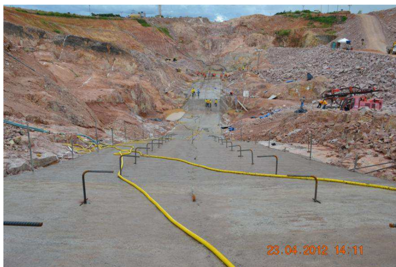
Figura 3.17: Concretagem de regularização da fundação e instalação dos chumbadores de ancoragem - UHE Jirau (RAMALHO et al., 2013)
