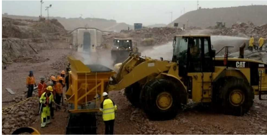
Figura 3.22: Carregadeira adaptada para o lançamento do concreto asfáltico - UHE Jirau (RAMALHO ET AL., 2013)
