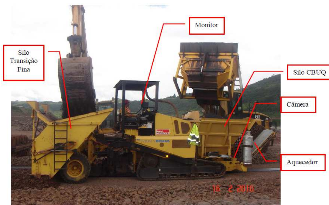
Figura 2.16: Equipamento de Aplicação do Núcleo Transição Fina de 3ª Geração, e Escavadeira de Apoio (GUIMARÃES, 2012)
