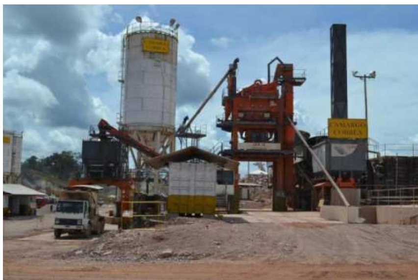
Figura 3.13: Usina de Concreto Asfáltico da UHE Jirau (RAMALHO et al., 2013)
