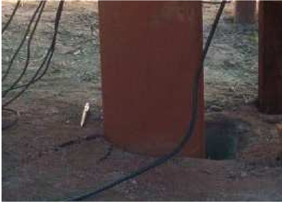
Figura 2.8 - Detalhe das trincas e intumescimento do solo na parte frontal da estaca (GUIMARÃES, 2007).
