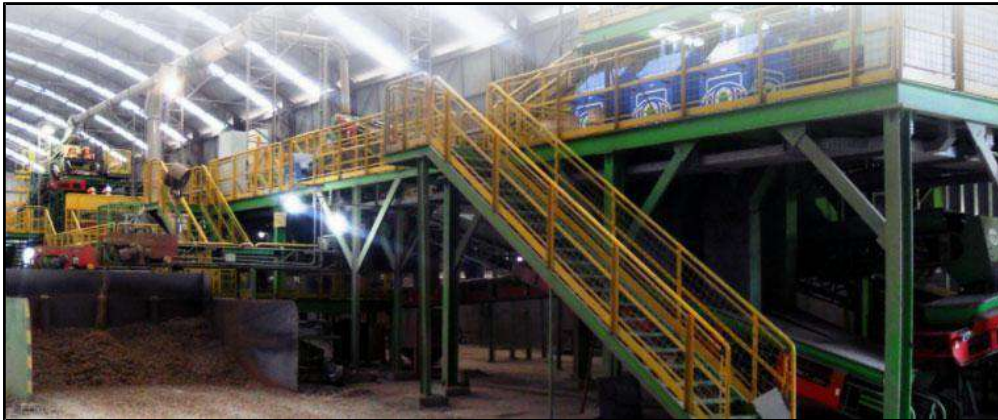
Figura 28: Usina automatizada de beneficiamento de caco na Vidroporto
