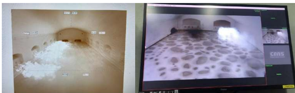
Figura 13: Visão interna de fornos side port e end port
