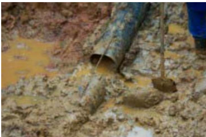
Figura 1-3 – Detalhe do rompimento do OLAPA
